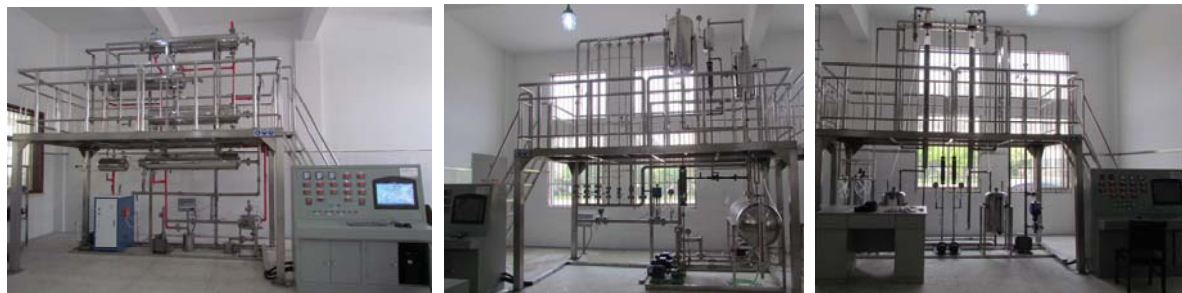
图 4 部分专业实训装置
